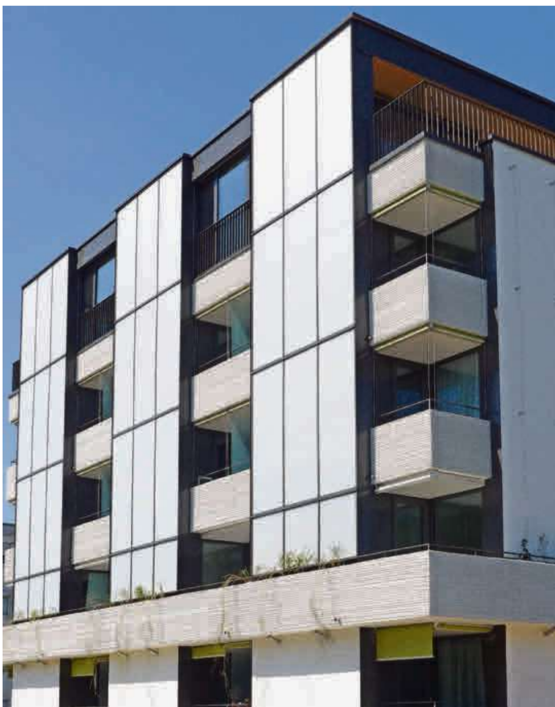
Von aussen sieht man nichts: Sonnenkollektoren an der Fassade produzieren Warmwasser.
